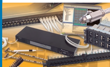
Управление кабельной инфраструктурой
